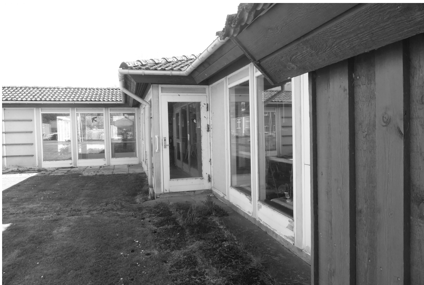
Glasgangen med dårligt vedligeholdte vinduer
