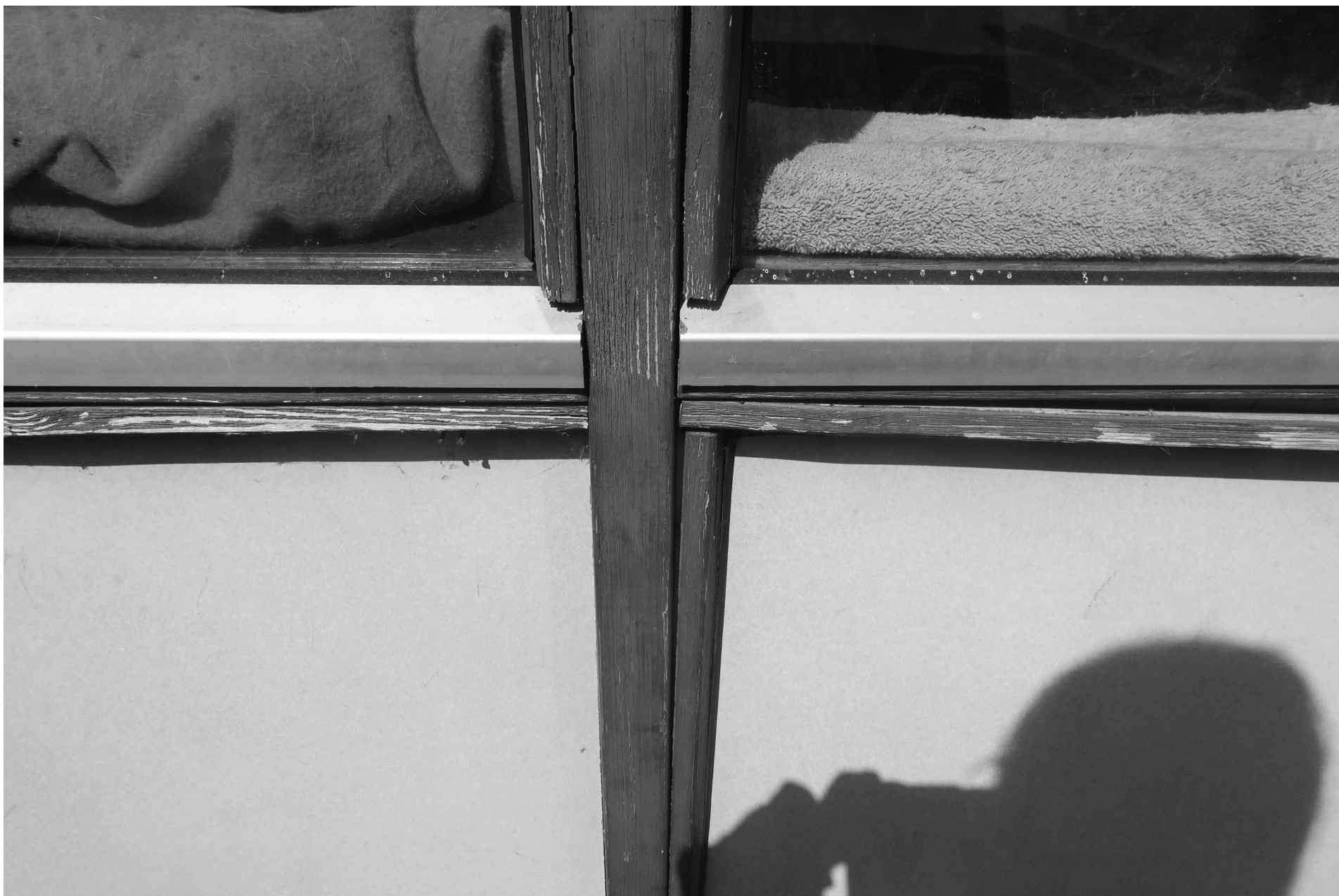
Vinduer i en bolig i SKÆP - har aldrig været vedligeholdt med maling
