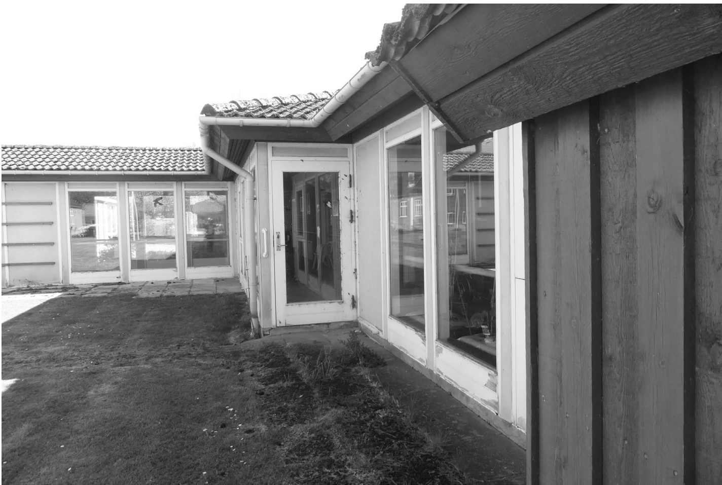
Glasgangen med dårligt vedligeholdte vinduer
